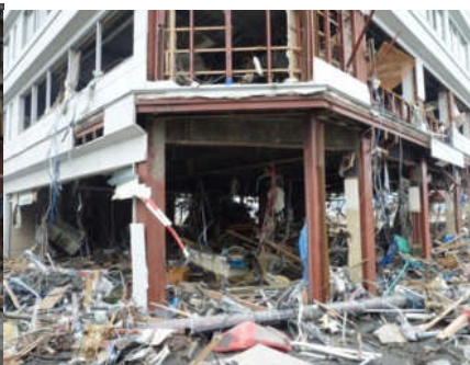
破壊された中心部の店舗
